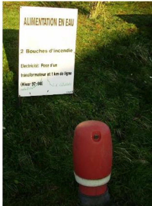
Figure 5 : Bouche d'incendie localisée au centre du site
